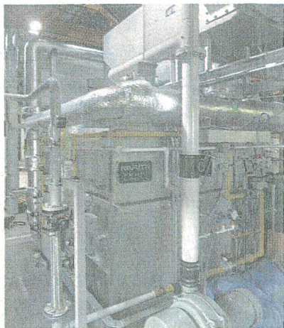
今月火入れした熱交換器搭載・省エネタイプの熱処理炉
